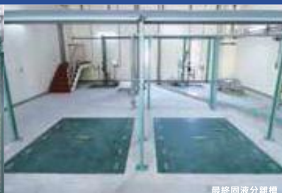
最終固液分離槽
